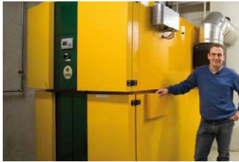
Spitzenlastkessel Biomasse, Gas, Öl
