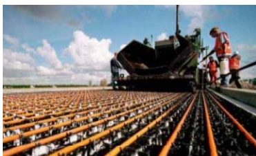
Asphaltkollektoren 5% bebaub. Fläche 2,2 GWh/a
