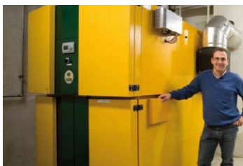
Spitzenlastkessel Biomasse, Gas, Öl
